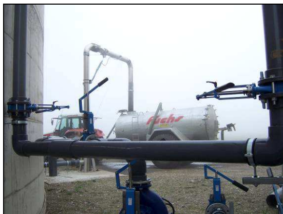
Фиг. 7.15 Изолирани газови тръбопроводи (вляво) и тръбопроводи за вторичната биомаса (вдясно) (RUTZ, 2008 г.)
