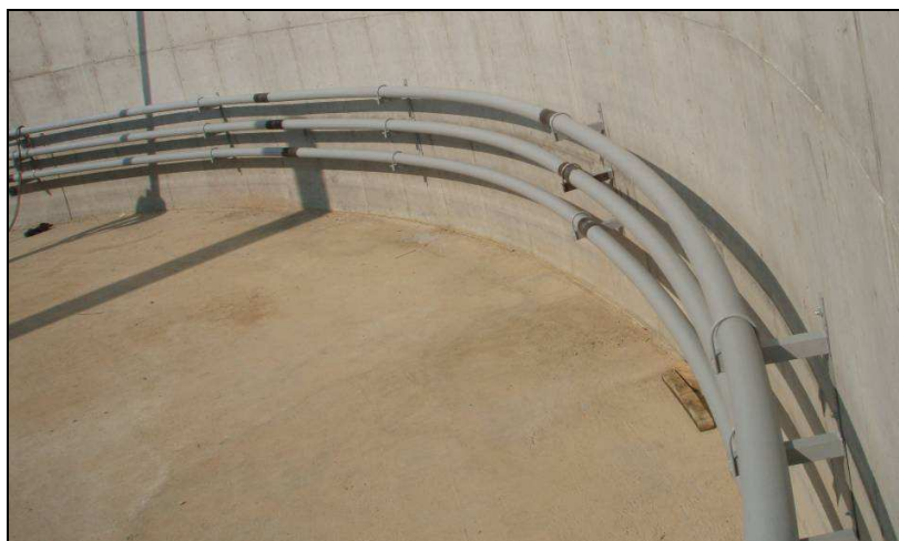
Фиг. 7.17 Отоплителни тръби в биореактора (AGRINZ GmbH, 2008 г.)
